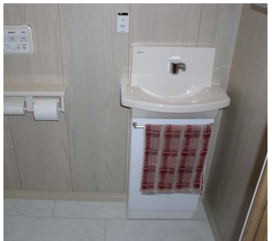
② 旧小便器側 大・小を1つのスペースにまとめた事で収納付の手洗いを設置するスペースが出来た
